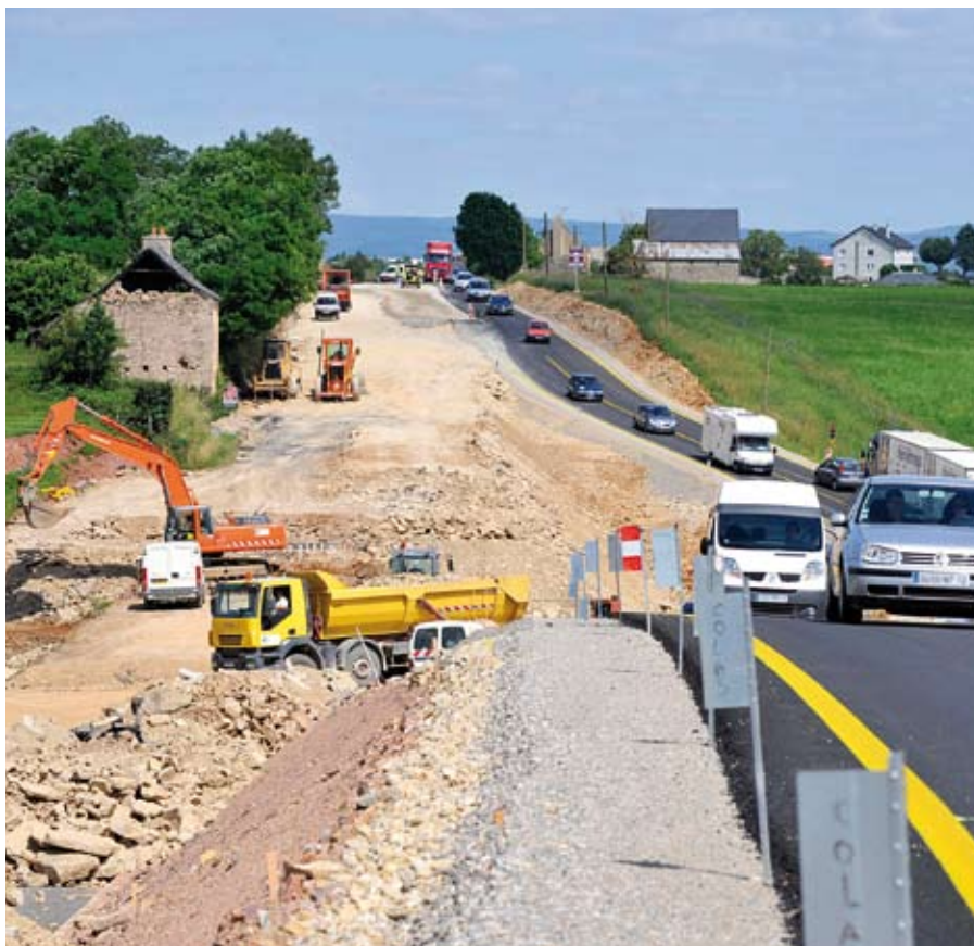
Le chantier de Bouldou près de Rodez, exemple de l'effort d'investissement du Conseil général
