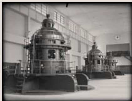
La salle des turbines
