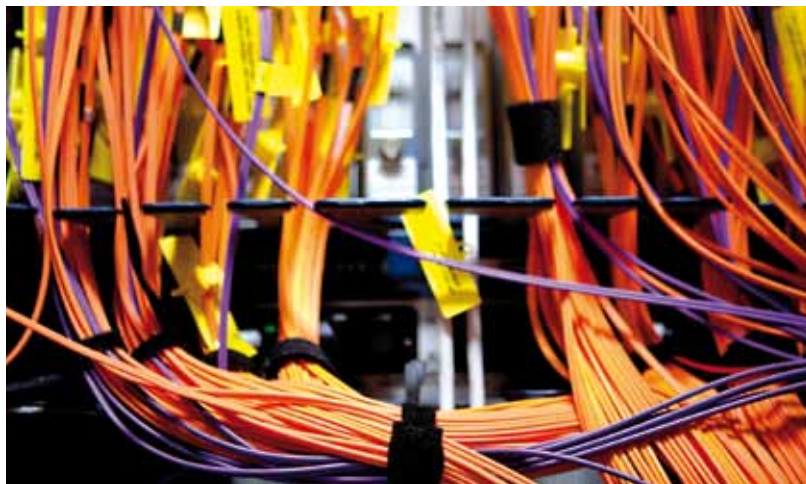
La technologie NRAZO mise en place par France Télécom
